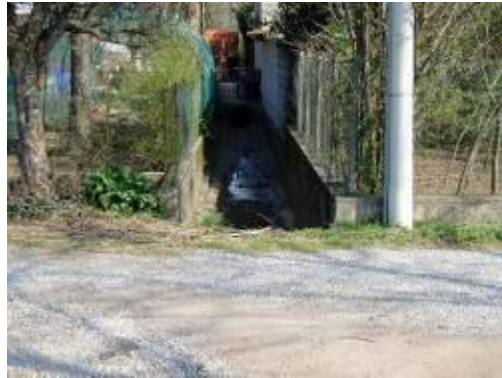
Figura 38: Particolare delle sponde cementate della Roggia Ghiringhella
