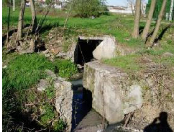
Figura 42: Particolare delle sponde in cemento della Roggia Reverta, a sud del villaggio Farinotti
